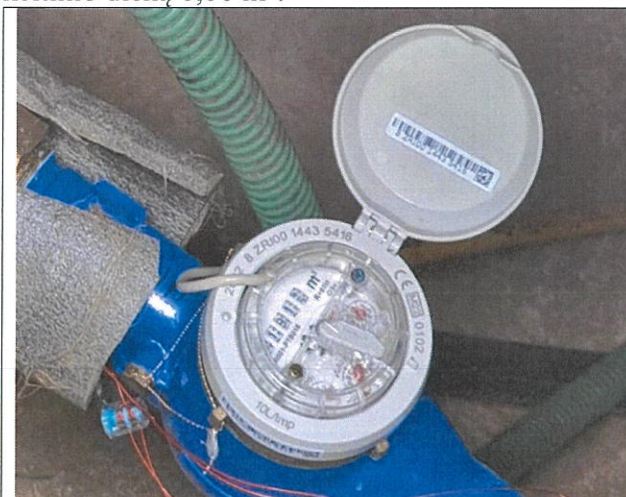
1 pav. Gręžinyje Nr. 39847 įrengtas vandens apskaitos prietaisas Nr. 8ZRI00 1443 5416. 2023-06-02 užfiksuoti rodmenys – 1181 m 3 .
